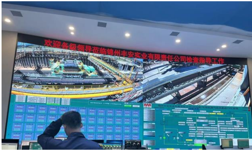
图 27 5G 能耗管控系统及企业级的统一数据平台界面
